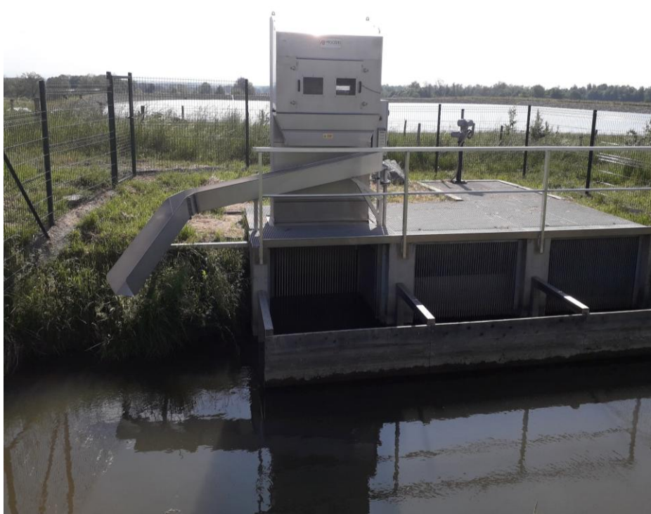
Dégrilleur devant la prise de la retenue de Villeroy
