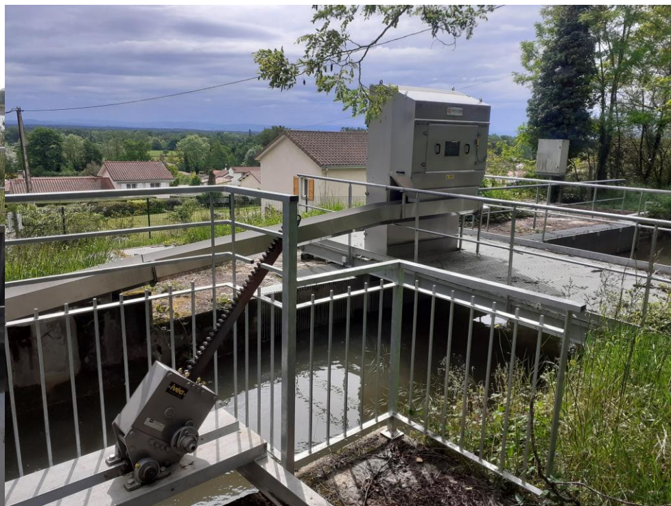
Dégrilleur et vanne clapet de St Paul
